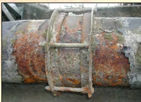
Canalisation corrodée - Cliché CCTA
